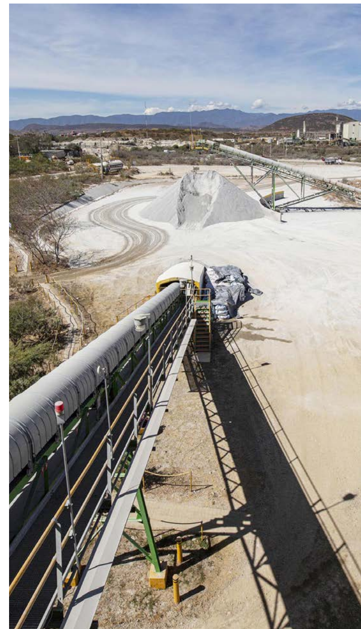
▼ Guardas de seguridad en las fajas transportadoras de mina San José
